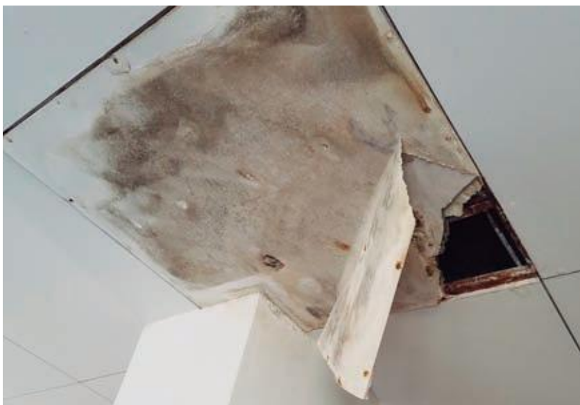
中学校玄関の天井崩落
