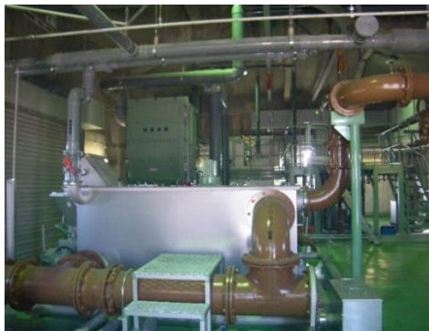
【管理棟内機械設備】
