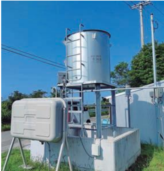
センサーを取り付けた重油タンク
